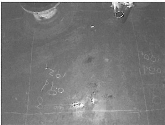
写真8 タンク本体の断熱材解体後の腐食状況
