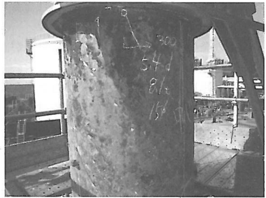
写真9 脚柱の耐火材除去後の腐食状況
