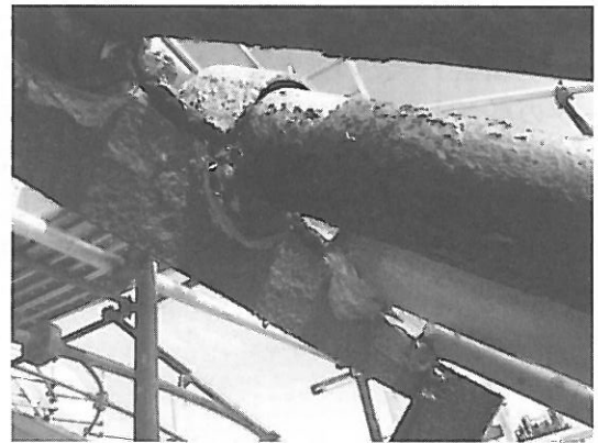
写真10 敷設配管の保冷材除去後の腐食状況
